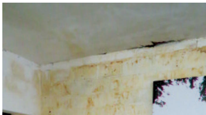
Een lek in het dak van het memoriaal zorgt voor dringende herstellingswerken... alle financiële steun is welkom !
