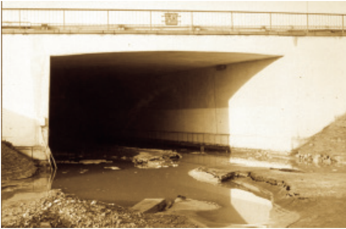
Hier ziet men de vernietigende kracht van het water onder de brug van de autostrade.
